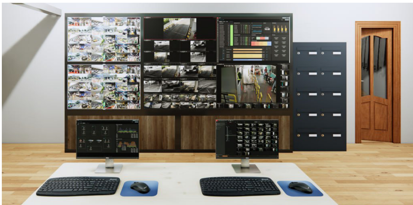
HỆ THỐNG QUẢN LÝ NHÀ ĐỂ XE (SÂN BAY TÂN SƠN NHẤT) PARKING MANAGEMENT SYSTEM (TAN SON NHAT INTERNATIONAL AIRPORT)
