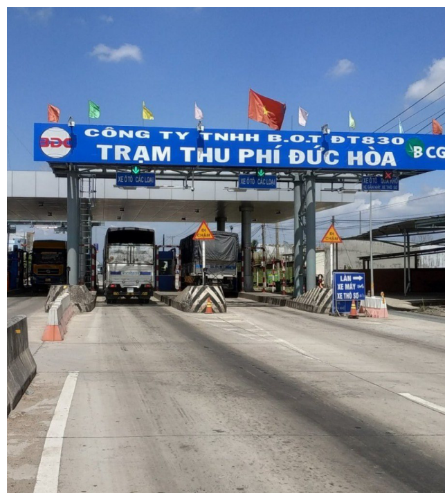
HỆ THỐNG THU PHÍ TỰ ĐỘNG (ĐỨC HÒA - LONG AN) ETC SYSTEM (DUC HOA - LONG AN)
