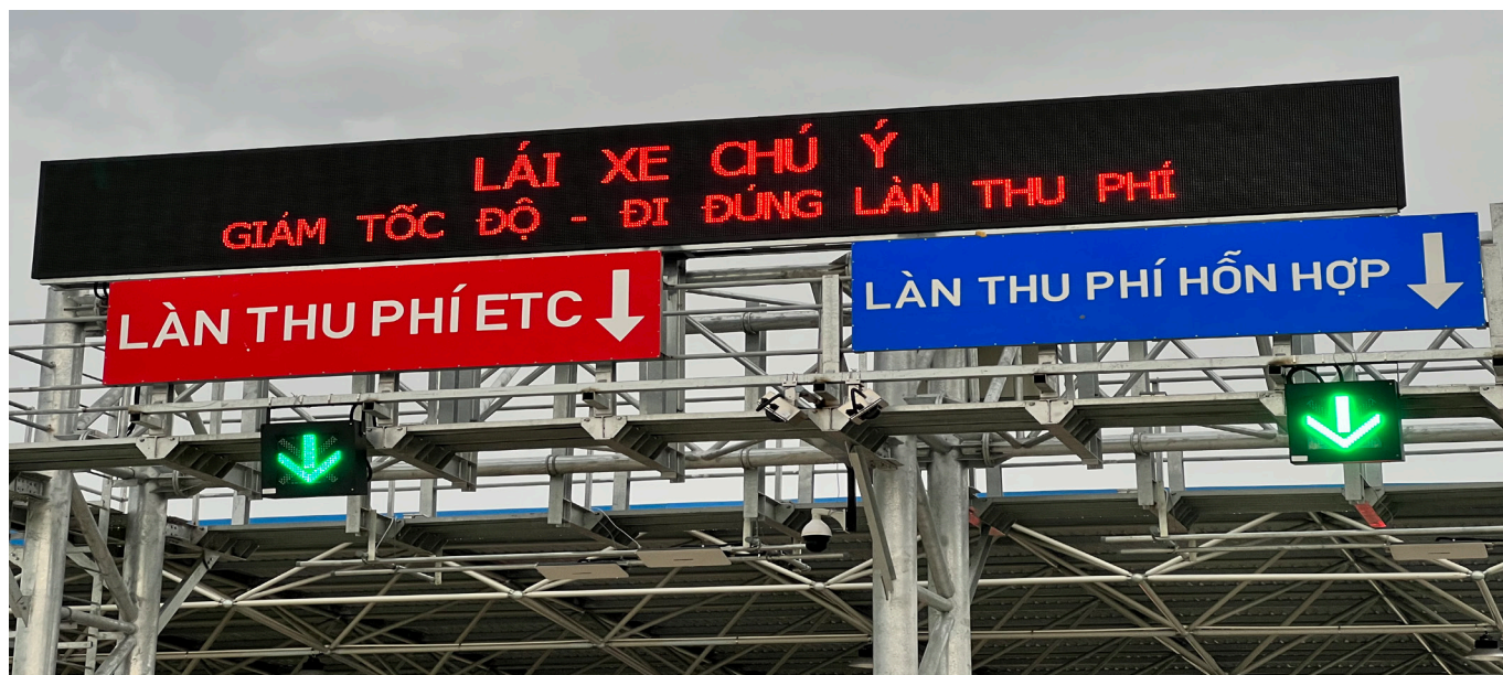
HỆ THỐNG BẢNG THÔNG TIN KHẢ BIẾN (CAO TỐC TRUNG LƯƠNG - MỸ THUẬN) VARIABLE MESSAGE SIGNS – VMS SYSTEM (TRUNG LUONG - MY THUAN EXPRESSWAY)
