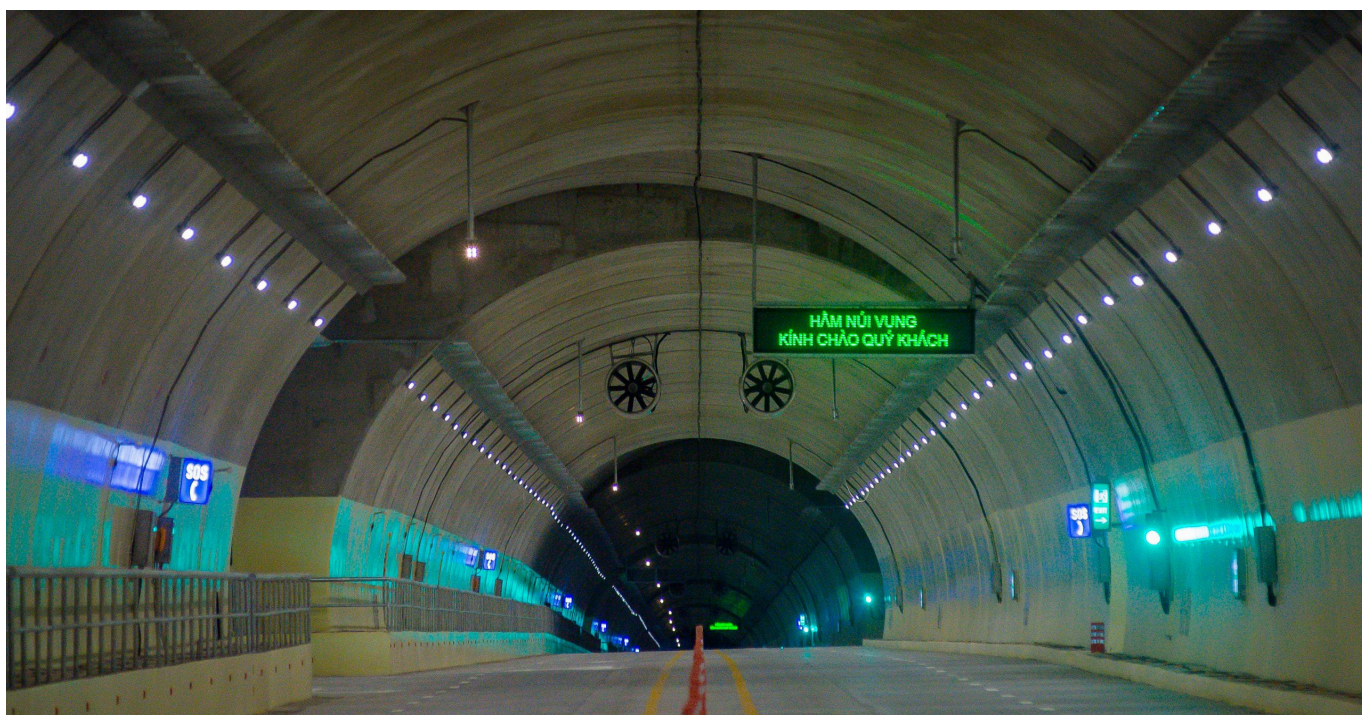
HỆ THỐNG HƯỚNG DẪN GIAO THÔNG (HẦM NÚI VUNG) TUNNEL TRAFFIC GUIDANCE (NUI VUNG TUNNEL)
