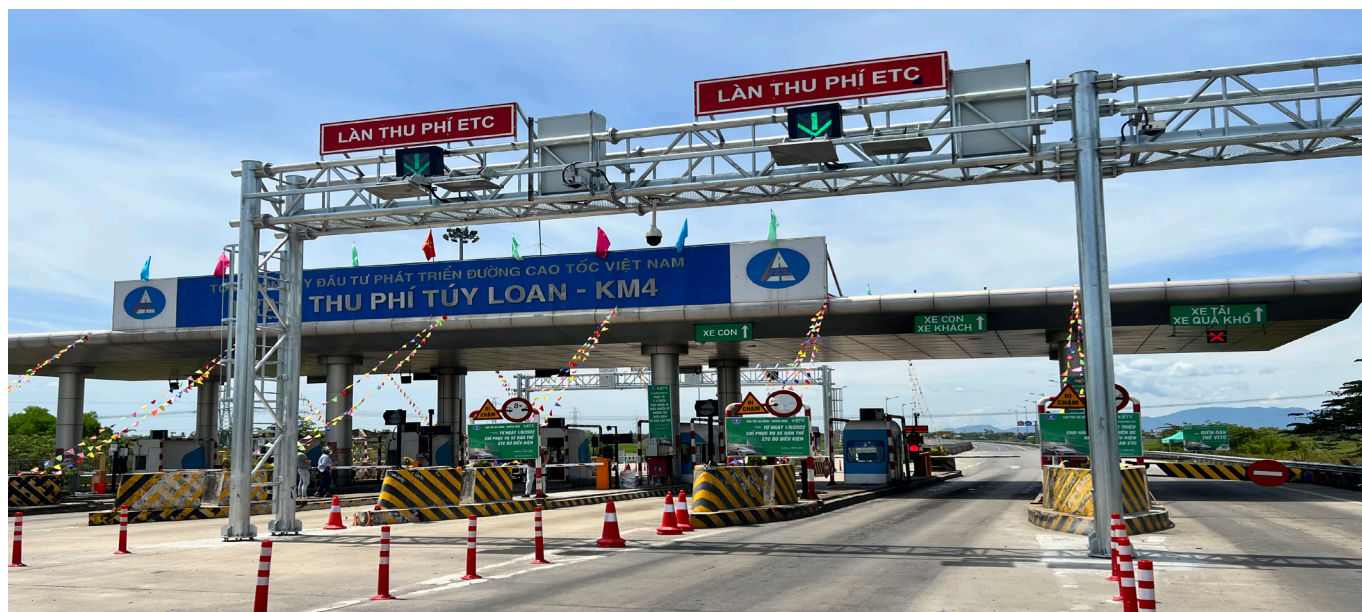
HỆ THỐNG THU PHÍ TỰ ĐỘNG (CAO TỐC ĐÀ NẴNG - QUẢNG NGÃI) ETC SYSTEM (DA NANG - QUANG NGAI EXPRESSWAY)
