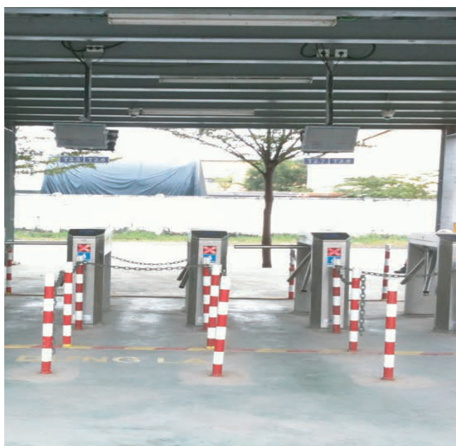
HỆ THỐNG KIỂM SOÁT NGƯỜI ĐI BỘ (PTSC - VŨNG TÀU) PEDESTRIAN GATE SYSTEM (PTSC - VUNG TAU)
