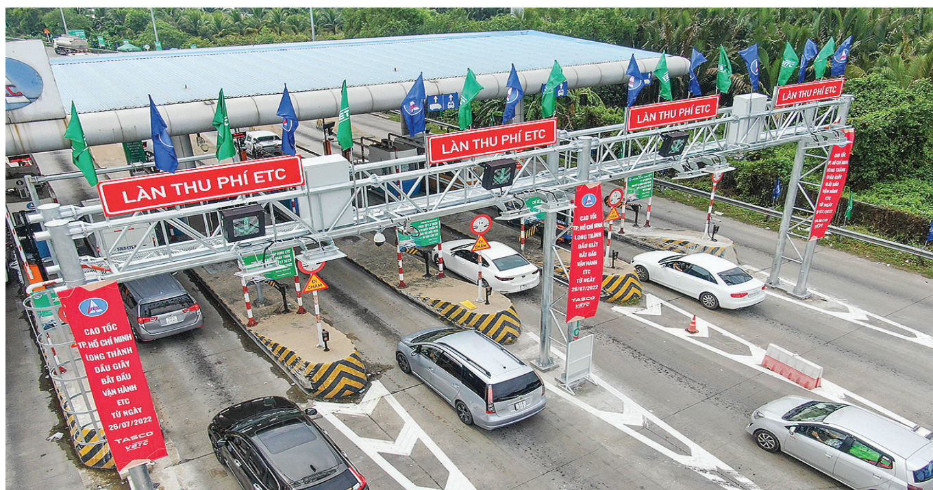
HỆ THỐNG THU PHÍ TỰ ĐỘNG (CAO TỐC HCM - LONG THÀNH - DẦU GIÂY) ETC SYSTEM (HCM CITY - LONG THANH - DAU GIAY EXPRESSWAY)
