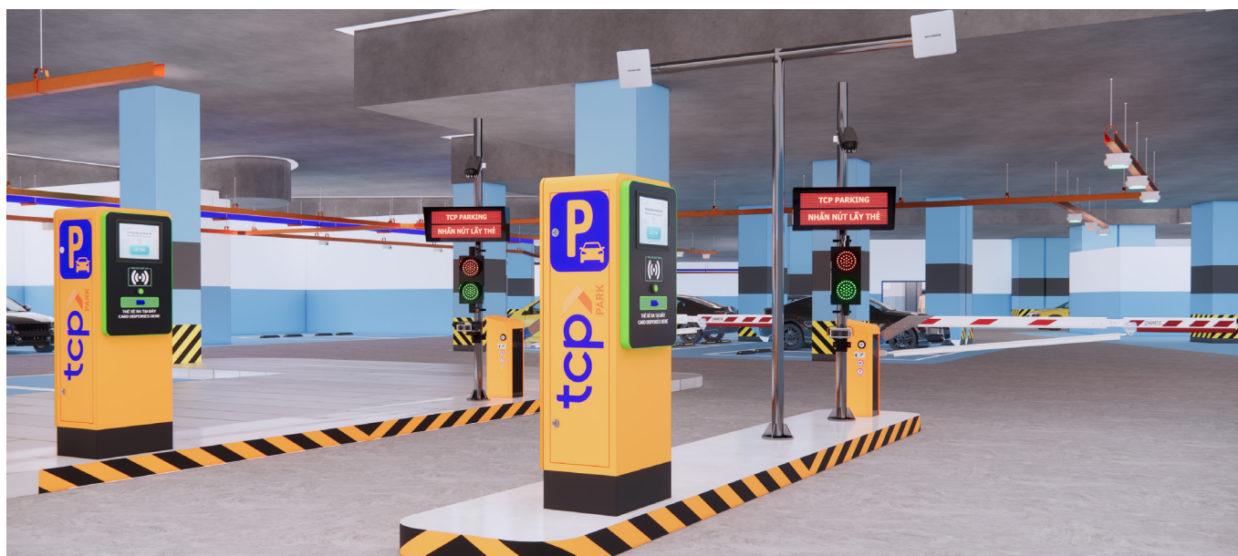
HỆ THỐNG KIỂM SOÁT & HƯỚNG DẪN ĐỖ XE ( NHÀ GA T3 SÂN BAY TÂN SƠN NHẤT) PARKING CONTROL & GUIDANCE SYSTEM (T3 TERMINAL TAN SON NHAT INTERNATIONAL AIRPORT)
