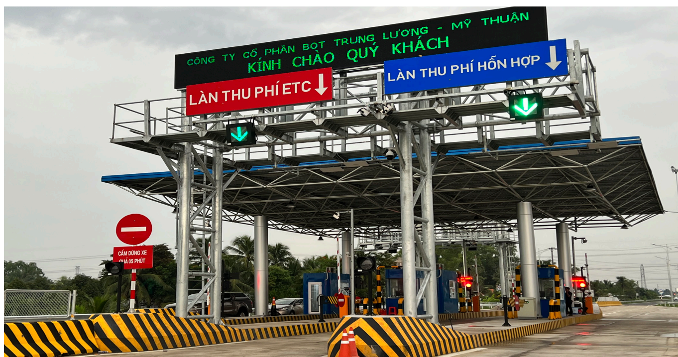
HỆ THỐNG THU PHÍ TỰ ĐỘNG (CAO TỐC TRUNG LƯƠNG - MỸ THUẬN) ETC SYSTEM (TRUNG LUONG - MY THUAN EXPRESSWAY)
