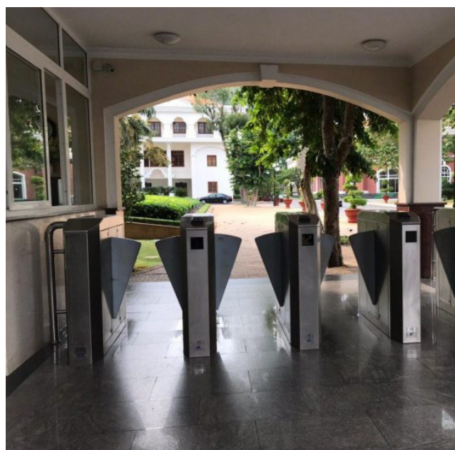
HỆ THỐNG KIỂM SOÁT NGƯỜI ĐI BỘ (VIETSOVPETRO - VUNG TAU) PEDESTRIAN GATE SYSTEM (VIETSOVPETRO)
